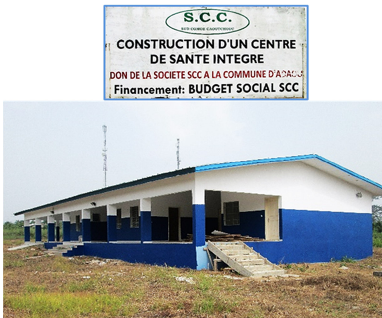
Photo 01 : Centre de santé rural dans le département d'Aboisso : Don de la SCC
