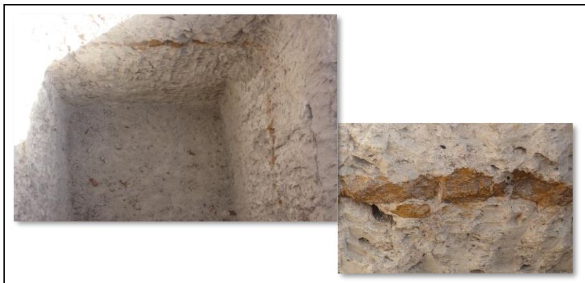
Figure 5: Blocs de pierres présentant des aspects de rouille (cliché ABANGA, 2022)
