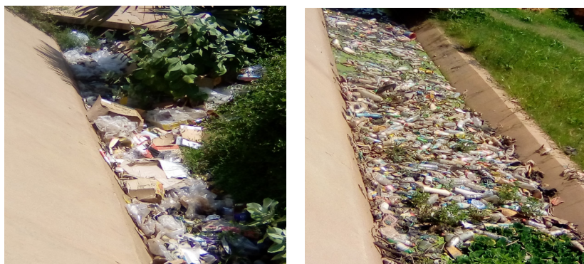
Planche 1. Obstruction des collecteurs par des déchets divers Source : travaux de terrain, février 2020
