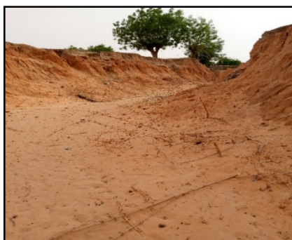
Photo 1: État de la ravine n°1 à la première mesure.
