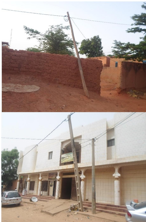
Photo 1 et 2 : Poteaux électriques en état de dégradation
