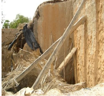
Photo 3 : Une maison en banco effondrée dans le quartier Lamordé
