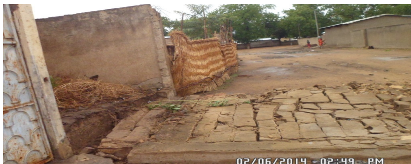
Photo 1. Murs faits en parpaings de moins en moins solides Prise de vue : Ovono Nogo, juin, 2014
