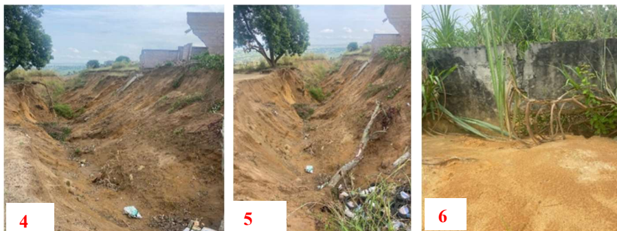
Photo 4-5-6 : état des lieux d'un ravin et d'une zone de sédimentation à J. Opangault
