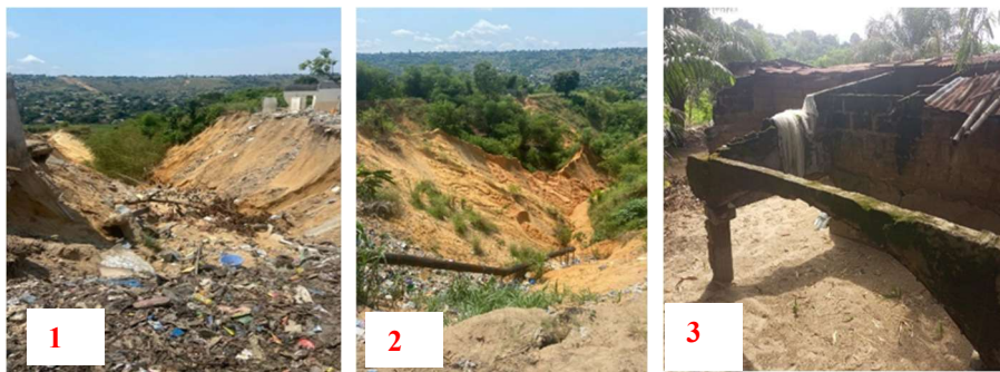
Photos 1-2-3 : état des lieux de trois têtes de ravins au quartier Nkombo Source : prise de vues des auteurs, mai 2025
