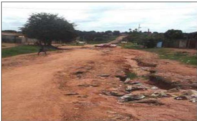
Photo 1 : Dégradation d'une voie dans le quartier de Belle-Ville 1 à Bouaké
