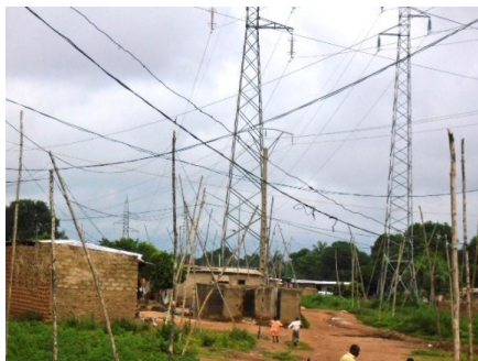
Photo 4 : branchement anarchique à Sossoroubougou au quartier Banco Source : Nos enquêtes, 2017
